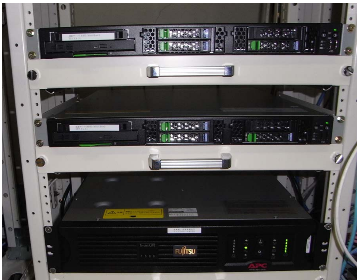
図2 新規導入された基板認証システムの設置状態
