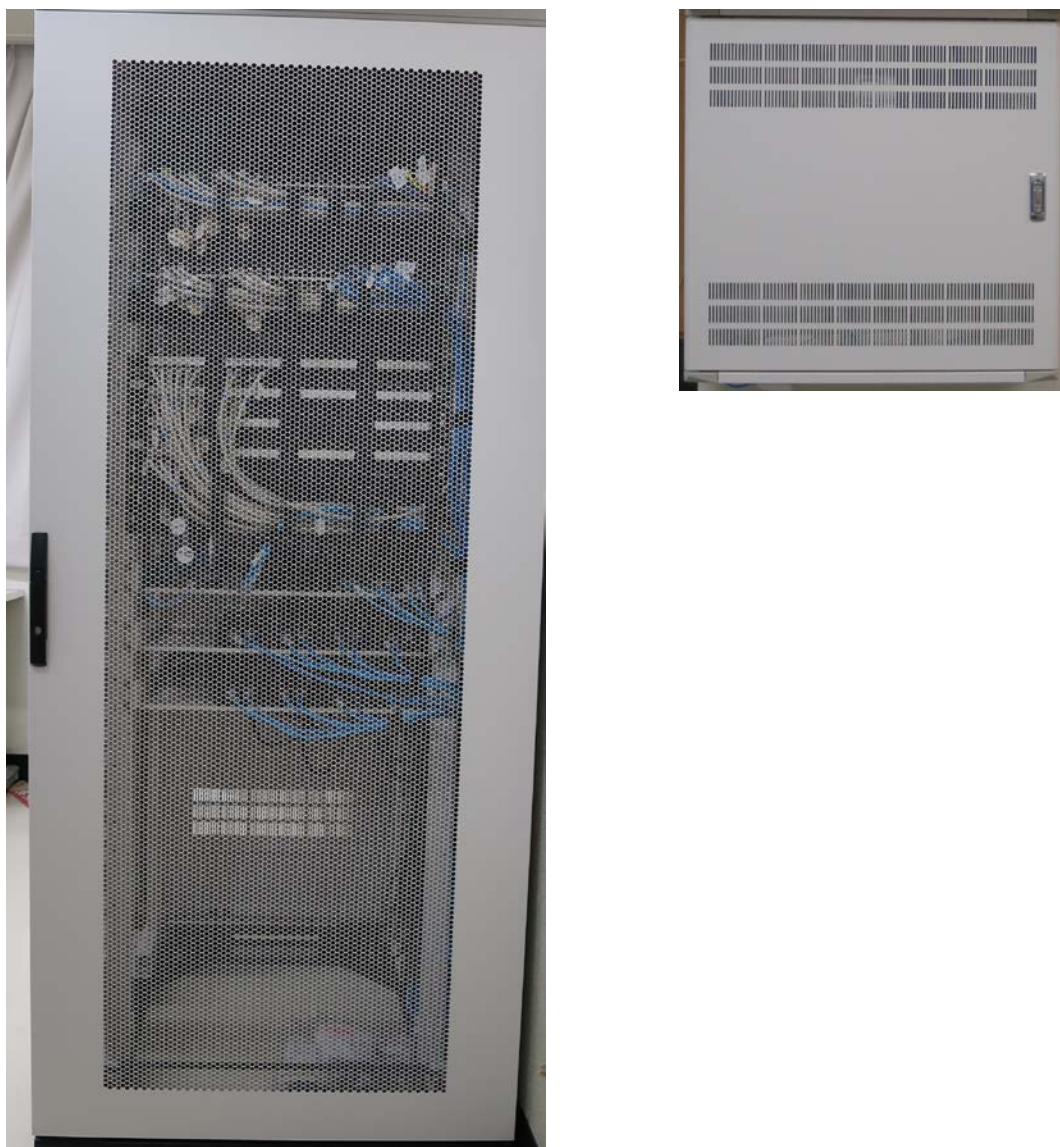
図1 第二学科棟ネットワークラック（左写真），第二講義棟ネットワークラック（右写真）
