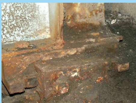
写真2 土砂堆積及び支承腐部食
