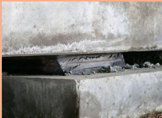
写真 ゴム支承の亀裂
