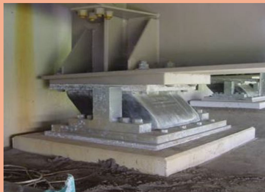
写真 ゴム支承の変形
