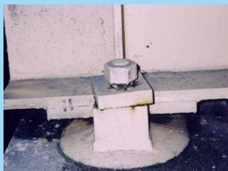
写真3 アンカー・ボルトナットのゆるみ
