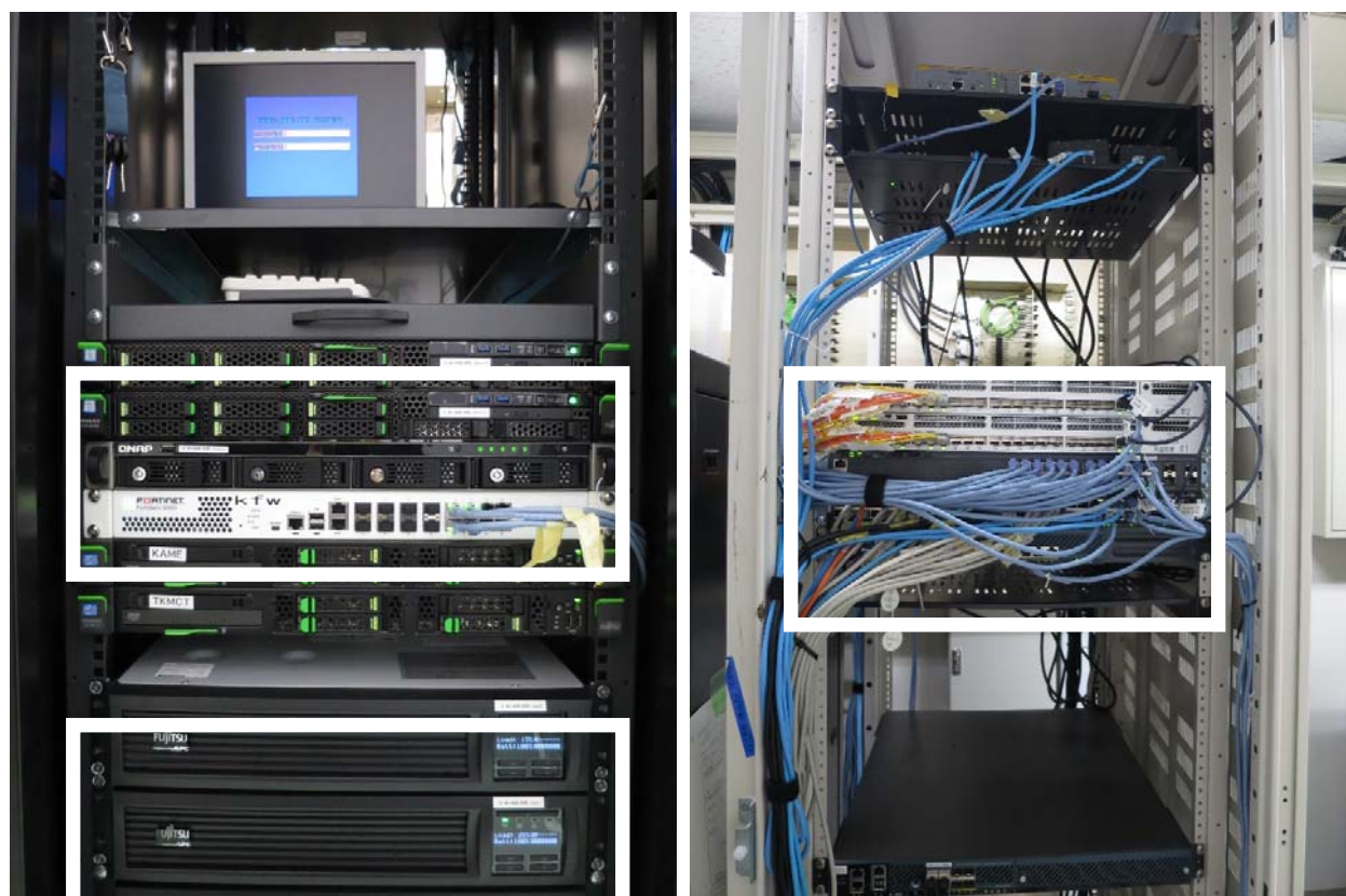
図 1 高専統一ネットワークシステム 仮想サーバ基盤 2 台, NAS, ファイアウォール, UPS 2 台 (左) センタースイッチ 2 台, エッジスイッチ, サーバスイッチ, 無線 LAN コントローラ (右)
