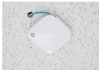
詫間キャンパス サイバー・ラボの無線LAN機器
