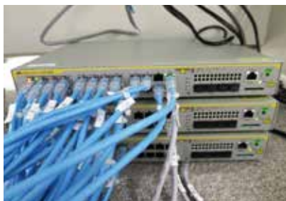
詫間キャンパス サイバー・ラボの有線LAN機器
